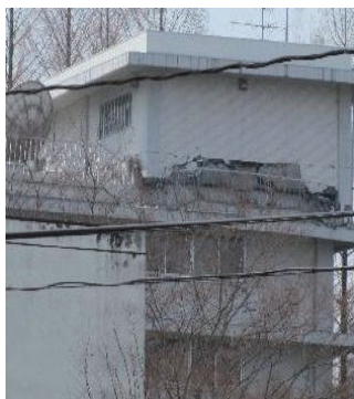
校舎の上階が被災した例
